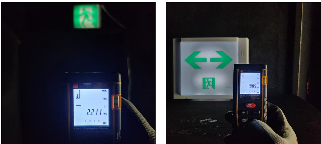
<그림 4-8> 유도등 설치 사진
